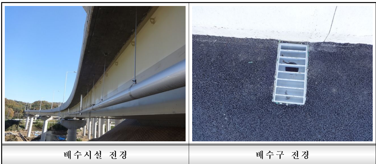
【표 2.1-2】 배수시설 손상물량
